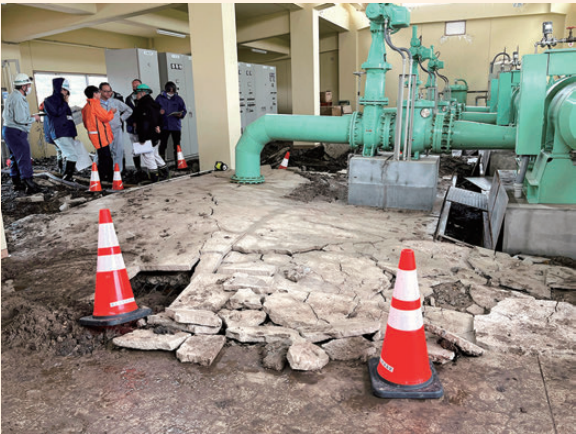
R7.4.14 大曽根揚水機場被害状況
