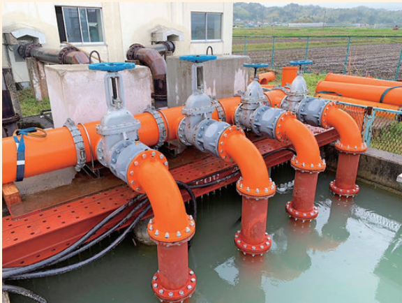
R7.5.1 仮設ポンプ設置状況
